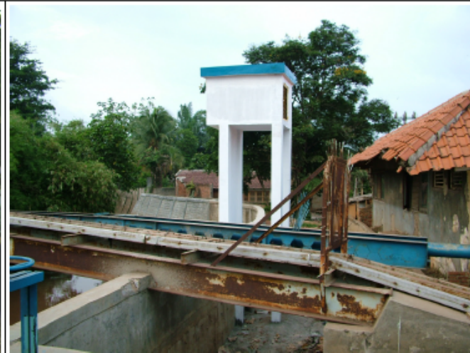
Stasiun TMA Ciledug, Telemetri PU DKI, 2009
