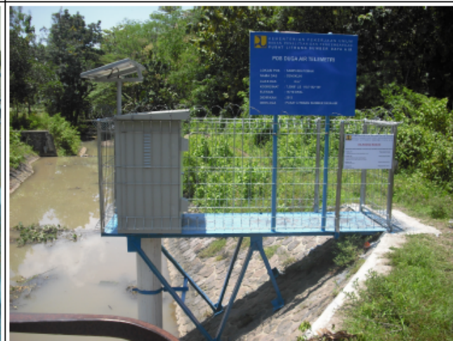
Stasiun TMA Bendung Cengklik, Puslitbang Air, Proyek DOISP, Loan IBRD, 2012
